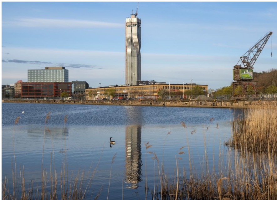
Resan mot toppen av Nordens högsta byggnad börjar nära sitt slut. Under kvartalet har kärnan i Karlatornet gjutits klart och endast ett fåtal meter återstår innan Karlatornet når full höjd i sommar.
